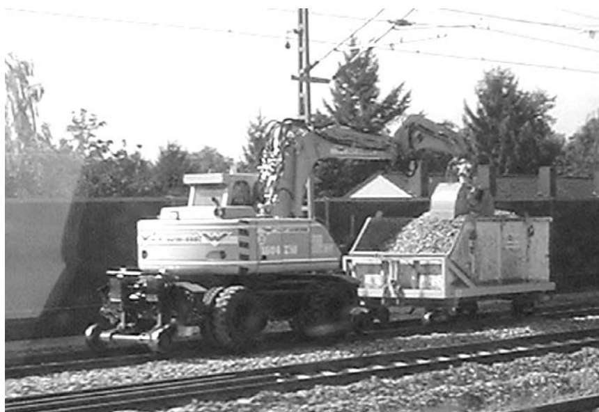
Rys. 7. Koparka dwudrogowa ze specjalnym wózkiem w trakcie wykonywania poprawek oprofilowania podsypki (Kolonia – Aachen, IX. 2002)
