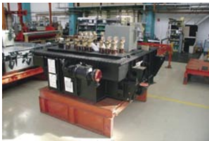
Fot. 2. Transformator główny
