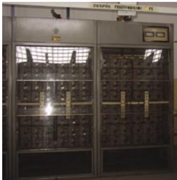
Fot. 4. Dwie z trzech szaf prostownika zespołu typu PK-17
