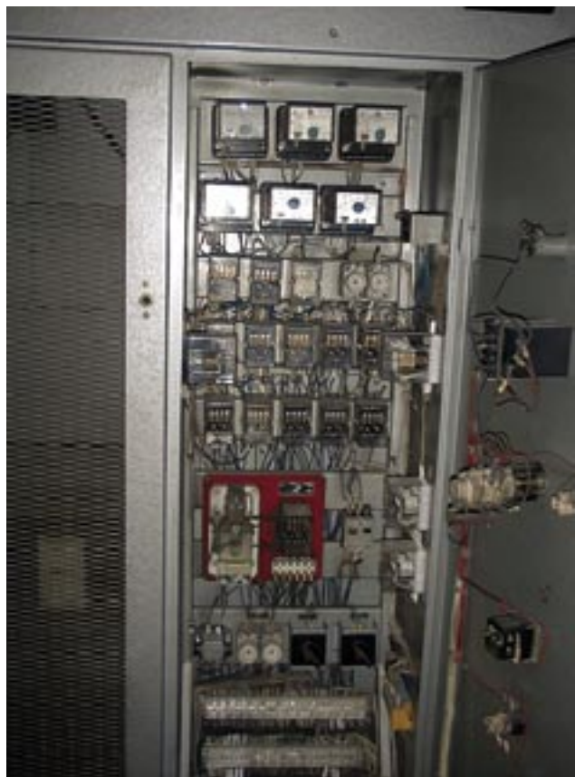
Fot. 14. Automatyka celki zasilacza wykonana w oparciu o przekąźniki
