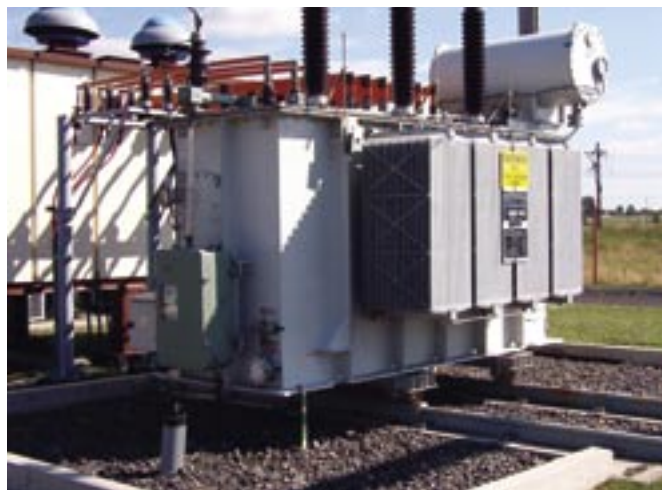
Fot. 2. Transformator prostownikowy zespołu typu PD-17/3,3
