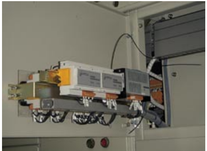
Fot. 13. Mikroprocesorowe urządzenia automatyki celki zasilacza
