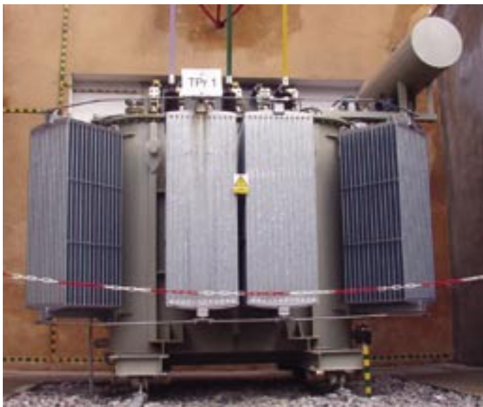
Fot. 3. Transformator prostownikowy zespołu typu PD-1,7/3,3
