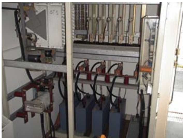
Fot. 7. Bateria kondensatorów filtru gamma
