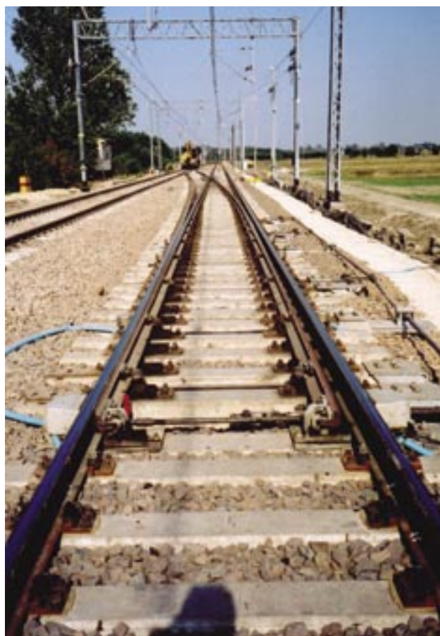
Fot. 4. Zwrotnica rozjazdu typu UIC60-1:18,5-1200 produkcji COGIFER, stacja Psary Fot. D. Korab
