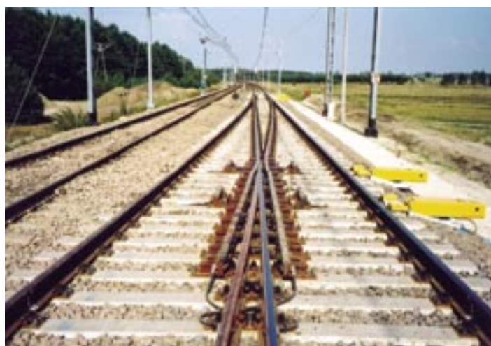
Fot. 2. Krzyżownica rozjazdu produkcji KolTram typu UIC60-1:18.5-1200, stacja Psary Fot. D. Korab
