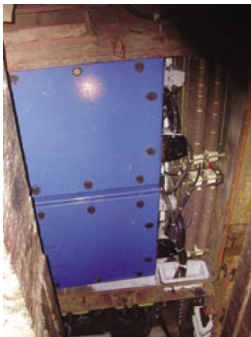
Rys. 1. Dwa falowniki typu ENI-F600/360/3H oraz dwa rezystory typu DTE-4 we wnęce po rozruszniku
