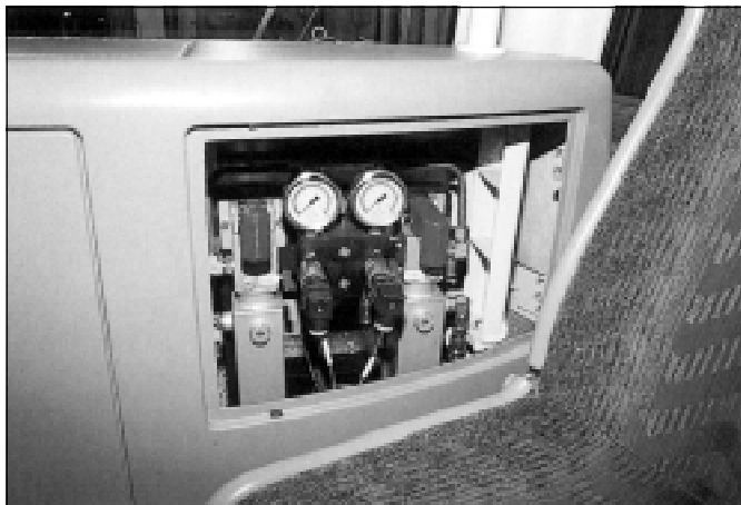
Fot. 13. Rostock – 4NBWE, pompy luzowników układu hamulcowego z akumulatorem sprężynowym
