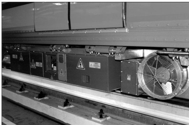
Fot. 12. Zespół przetwornicy
