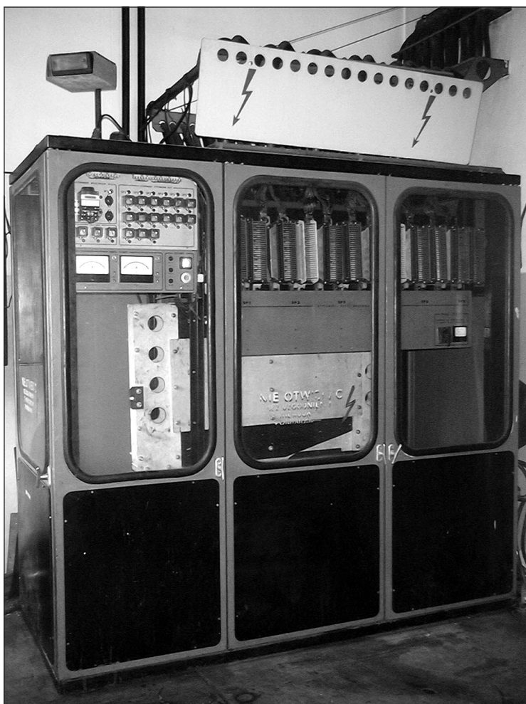
Fot. 2. Szafa aparaturowa wysokiego napięcia
