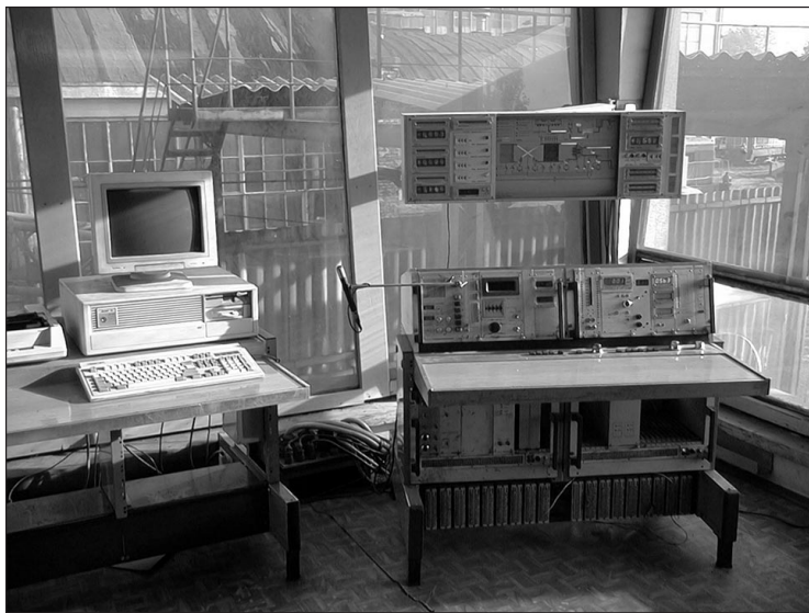
Fot. 2. Pulpit pomiarowo-sterowniczy i system komputerowy stacji
