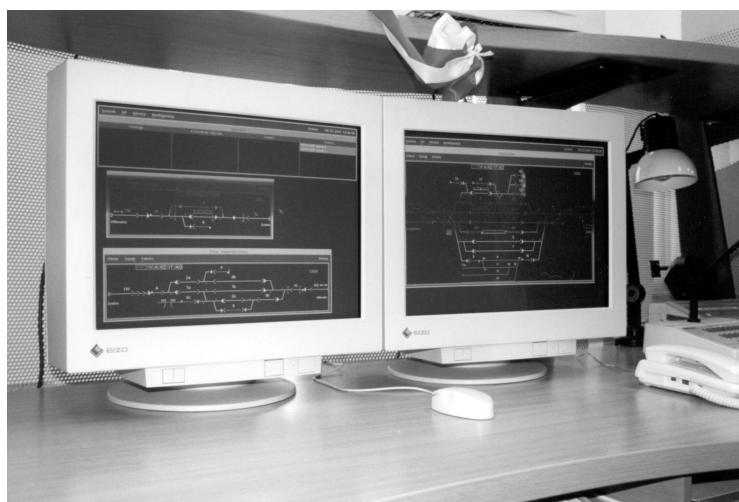
Fot. 4. Monitory wyświetlające schematy zasilania trakcji elektrycznej na całym sterowanym odcinku
