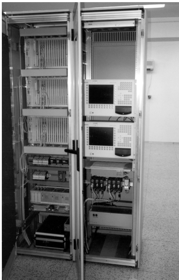
Fot. 3. Stojaki przełącznikowe. Systemy kontroli niezajętości toru
