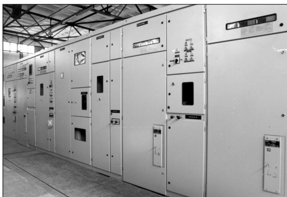
Fot. 3. Rozdzielnica do budynkowej podstacji Huta Zawadzka
