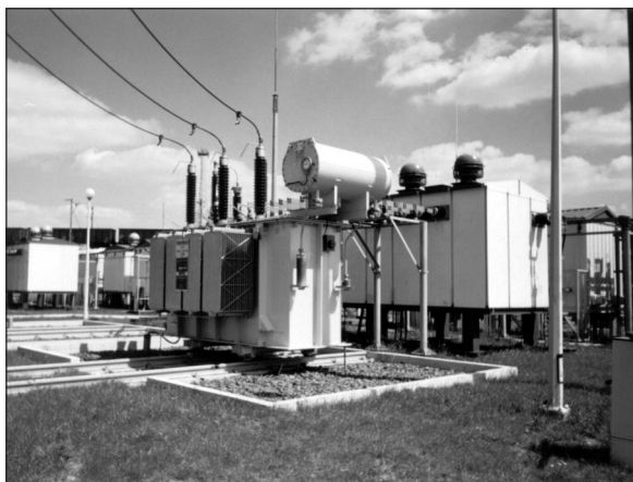
Fot. 2. Transformator czterouzwojeniowy w podstacji Barłogi
