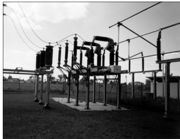
Fot. 1. Kompaktowa aparatura łączeniowa, zastosowana w podstacji Barłogi (Compass produkcji ABB) Fot. K. Tuliński
