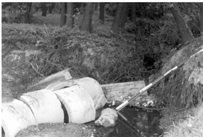
Fot. 1. Pozostałości po zniszczonym przepusie drogowym
