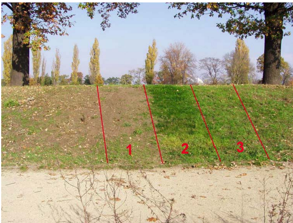
Fot. 6. Trawy na dywanowym drenażu naskarpowym wału przeciwpowodziowego we Wrocławiu; 1 – 2-letnia ruń trawiasta, 2 – odcinek wału z zaaplikowanym geokompozytem, 3 – 2-letnia ruń trawiasta, uzupełniona wsiewką traw, okresowo podlewana (fot. D. Garlikowski)
