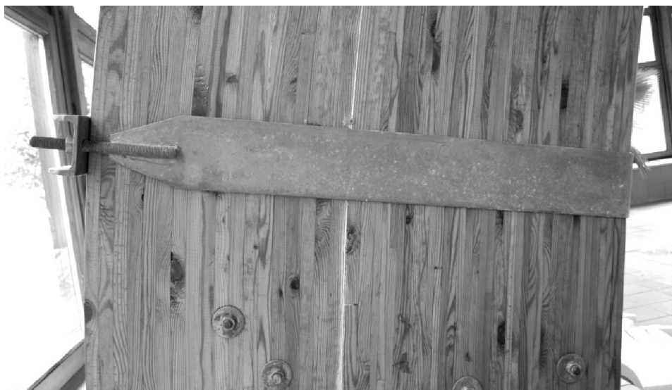
Fig. 1. Steel bandage element on the frame column in the pool at Hajdúszoboszló Rys. 1. Stalowa opaska na kolumnie szkieletu konstrukcji – basen w Hajdúszoboszló
