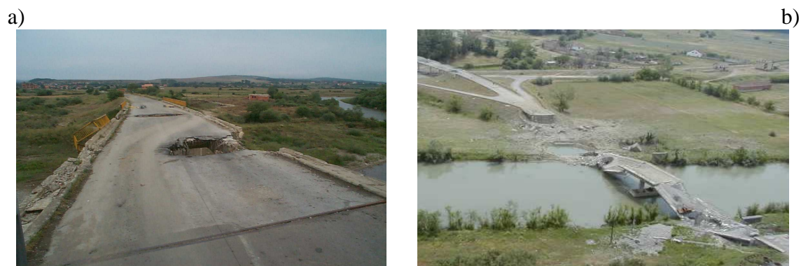
Rys. 4. Przykłady uszkodzeń z grupy II: a) uszkodzenie korony drogi, b) uszkodzenie przęseł mostu
