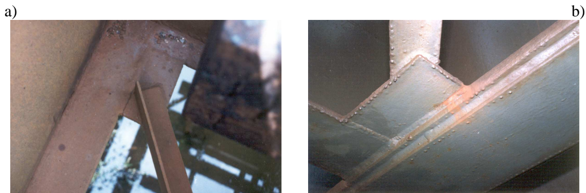
Rys. 5. Wyraźne pęknięcie w spoinie czołowej: a) widok z góry oraz b) widok od spodu
