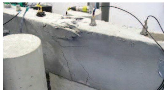
Rys.3. Utrata spójności betonu w miejscu statycznego obciążania belki.
