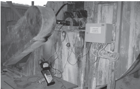
Rys. 1. Przykład wykonywania pomiarów drgań wentylatora przemysłowego oraz wyznaczania trajektorii ruchu wału
