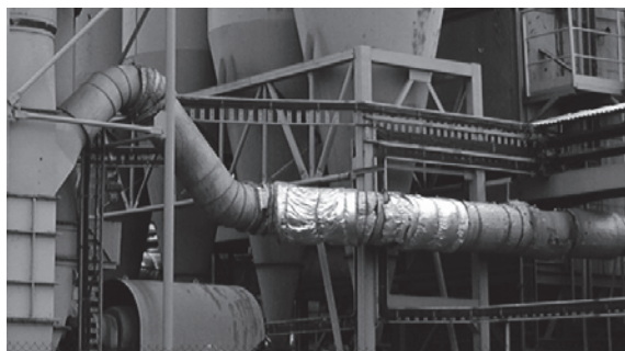
Rys.4. Przewody powietrzne ze zniszczoną izolacją Fig 3. Air ducts with damaged insulation
