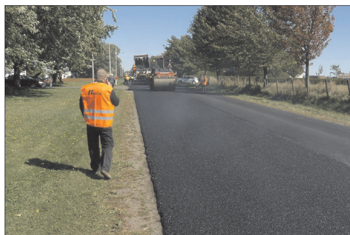
Fot. 6. Wbudowywanie mieszanki SMA związanej asfaltem modyfikowanym gumą (Victoriaville) (fot. H. Koba)
