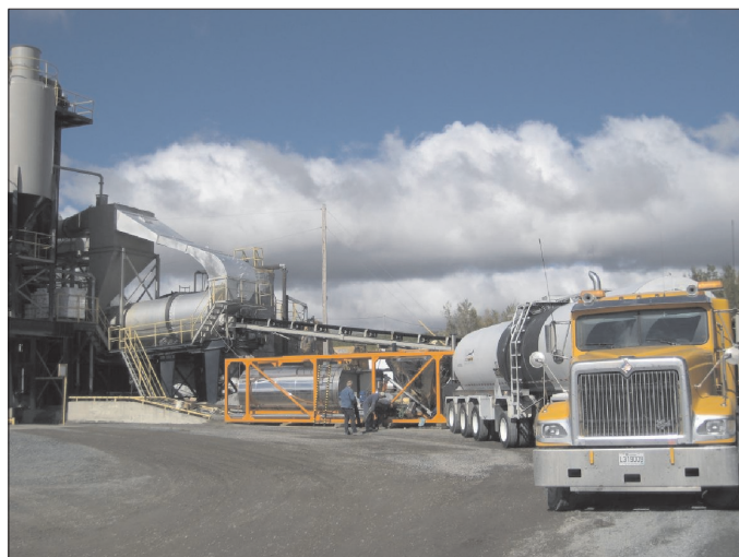
Fot. 4. Zestaw do modyfikacji asfaltu gumą na wytwórni mieszanek mineralno-asfaltowych (Victoriaville) (fot. H. Koba)
