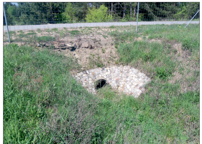
Fot. 5. Częściowo umocniony odpływ. Brak pełnego zabezpieczenia powoduje zamulanie wylotu (fot. M. Głazewski)
