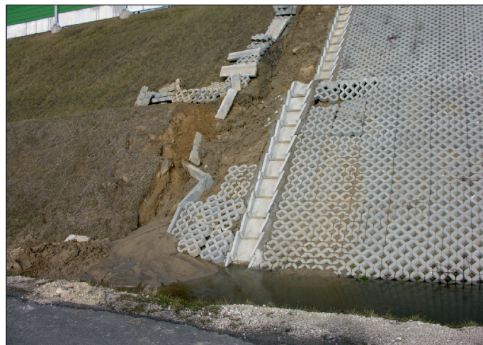
Fot. 1. Umocnienia betonowe zniszczone przez spływającą wodę ze skarpy (fot. M. Głażewski)
