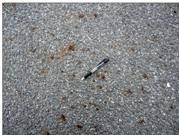
Fot. 1. Fragment nawierzchni na którym wystąpiły przebarwienia (fot. B. Grzesik)
