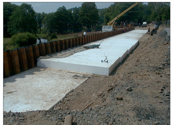
Fot. 3. Bloki styropianowe układane pod drogą wzdłuż ścianki szczelnej (fot. K. Grzegorzewicz)
