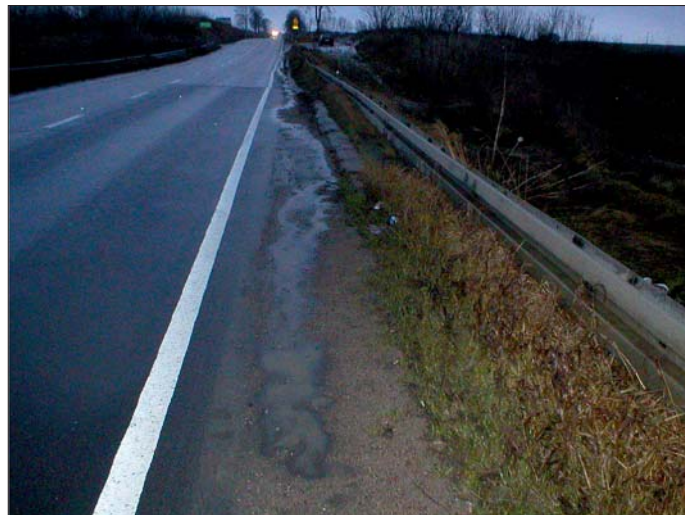
Fot. 1. Widok fragmentu drogi krajowej nr 63 przyległego do odcinka, na którym wystąpiło osuwisko nasypu (z nawierzchnią jezdni) (fot. Z. Szypcio, K. Dołżyk)
