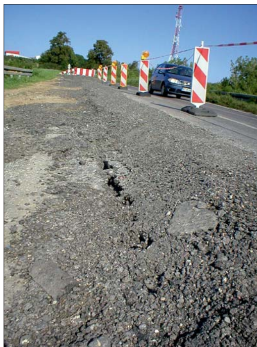
Fot. 2. Odcinek drogi krajowej nr 63, na którym wystąpiło osuwisko nasypu (z nawierzchnią jezdni) (fot. Z. Szypcio, K. Dołżyk)
