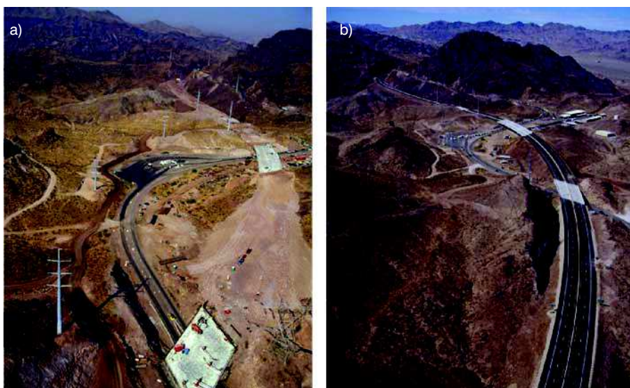
Fot. 6. Roboty drogowe i mostowe po stronie stanu Nevada a) w trakcie budowy; b) po jej zakończeniu
