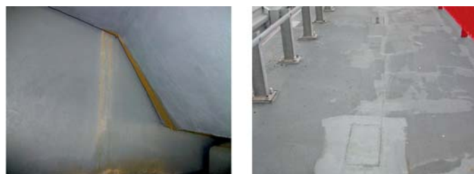
Fot. 2–3. Widoczne zacieki na spodzie płyty i ścianie zapleczonej. Widok spękań wzdłuż kanału odwodnienia liniowego
