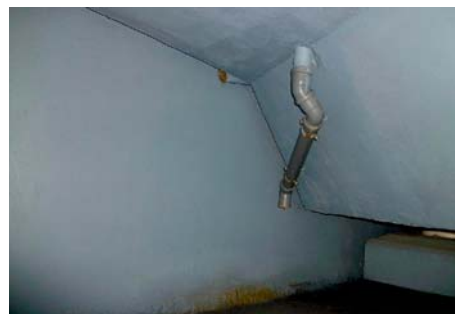
Fot.14. Efekt wykonania sączka z wyprowadzeniem rurą PCV (stan w dniu 12.12.2011 r.)
