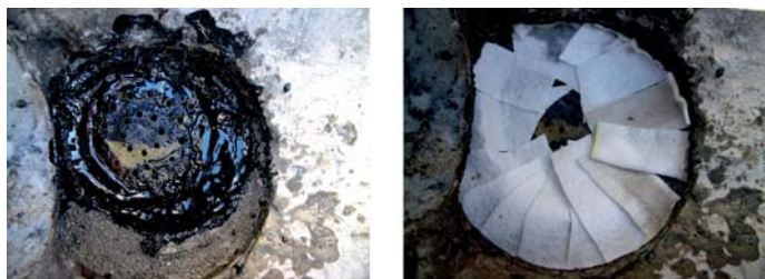
Fot. 6–7. Posmarowane masą bitumiczną sitko sączka. Wprowadzenie geowłókniny na sitko spod kanału odwodnienia liniowego
