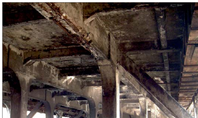
Fot. 3. Obraz korozji mostu
