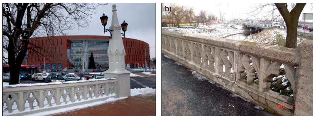
Fot. 9. Widoki balustrad: a) z 2012 r., b) z 2007 r.
