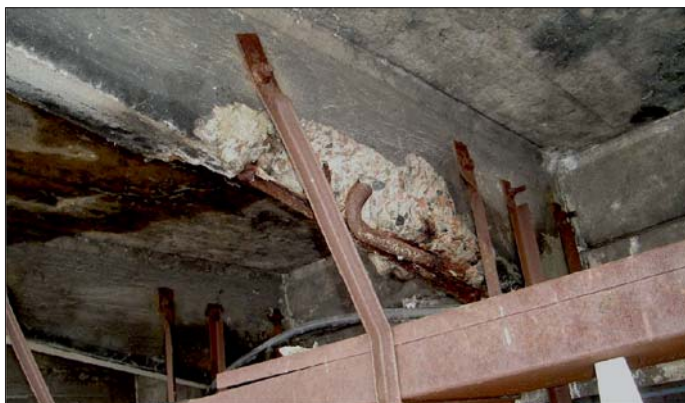
Fot. 4. Obraz prętów \varnothing = 32 mm zbrojenia głównego
