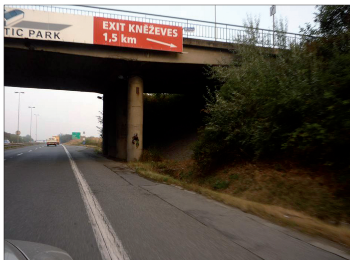
Fot. 4. W tym miejscu na autostradzie starszego typu, niewyposażonej w bariery przy podporach wiaduktu, zginęły dwie osoby w dwóch wypadkach
