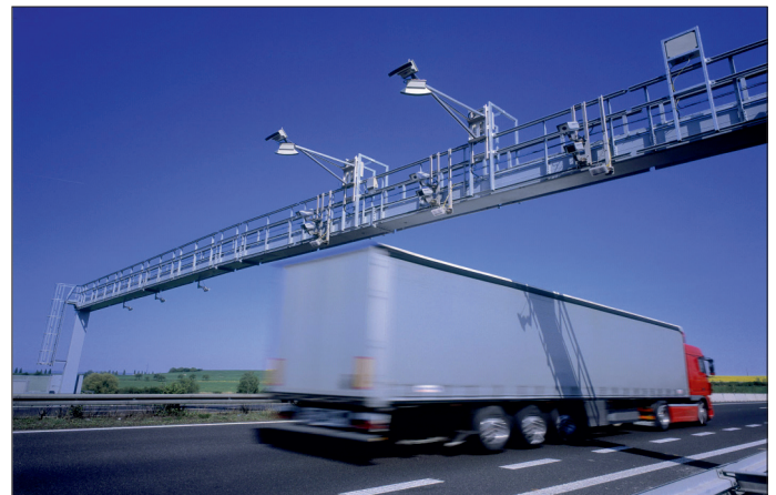
Fot. 5. Stale urządzenie kontrolne zainstalowane na bramownicy
