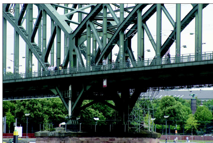
Fot. 2. Südbrücke: a) widok mostu z wysokiego budynku na lewym brzegu Renu, b) widok mostu z prawobrzeżnych terenów zalewowych, c) tożyska i przegub przęśła opartego na wsporniku
