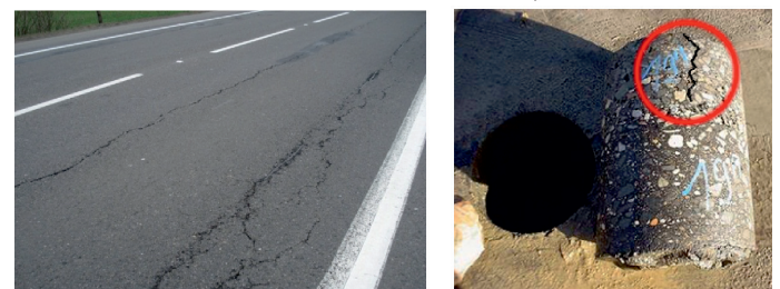
Rys. 2. Spękania typu „z góry na dół” o charakterze liniowym na DK Nr 1 (fot. Katedra Inżynierii Drogowej PG) – na odwiercie widać penetrację spękania w dół na kilka centymetrów
