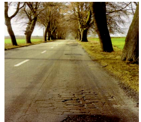
Rys. 1. Spękania typu „z dołu do góry” („ bottom – up ”) o charakterze siatkowym na DW Nr 222 (fot. Katedra Inżynierii Drogowej PG)
