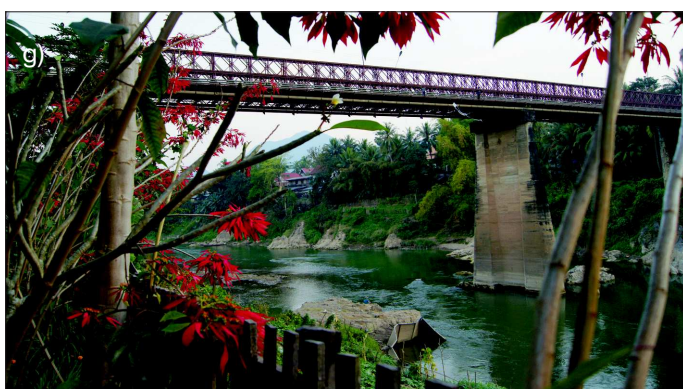
Fot. 2. Wojskowy most składany przez Nam Khan: a) widok mostu ze wzgórza w centrum miasta, b) wjazd na most od strony miasta, c) jezdnią, d) chodnik, e) zamocowania poprzecznic, f) zniszczenia słupków i krzyżulców jednego z elementów nośnych, g) widok przęsła i podpór spod mostu
