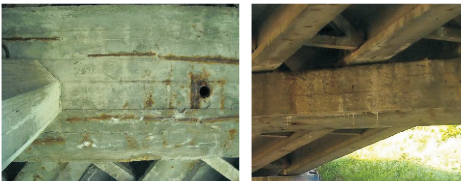
Fot. 13. Obraz uszkodzeń dolnej powierzchni oczepów – korozja zbrojenia, odpryski betonu, zawilgocenia, wykwyty [6]
