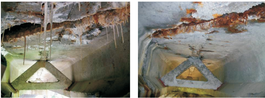
Fot. 11. Typowe uszkodzenia płyty pomostu – korozja, ubytki i osady betonu płyty wzdłuż szczeliny dylatacyjnej [6]
