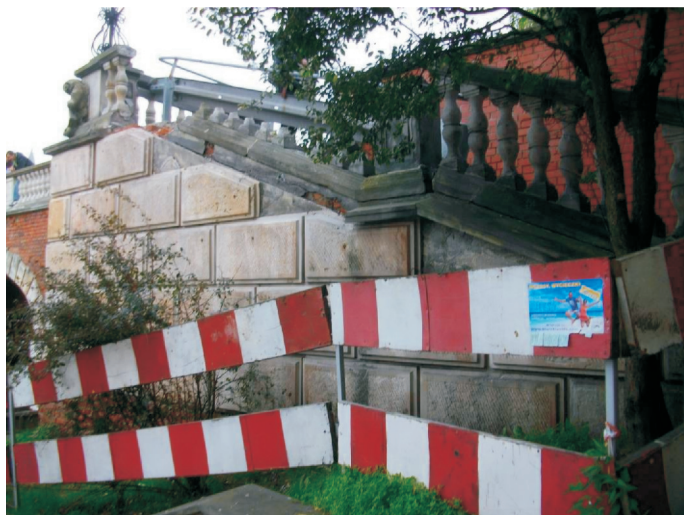
Fot. 5. Widok schodów wraz z uszkodzeniami: braki płyt licowych z kamienia, zniszczenie i degradacja balustrady [7]
