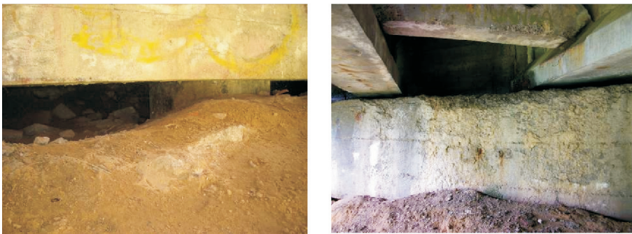
Fot. 12. Kawerna pod oczepem przyczółka o wysokości do 40 cm i głębokości do 140 cm oraz liczne zacieki, wykwyty i ubytki betonu [6]
