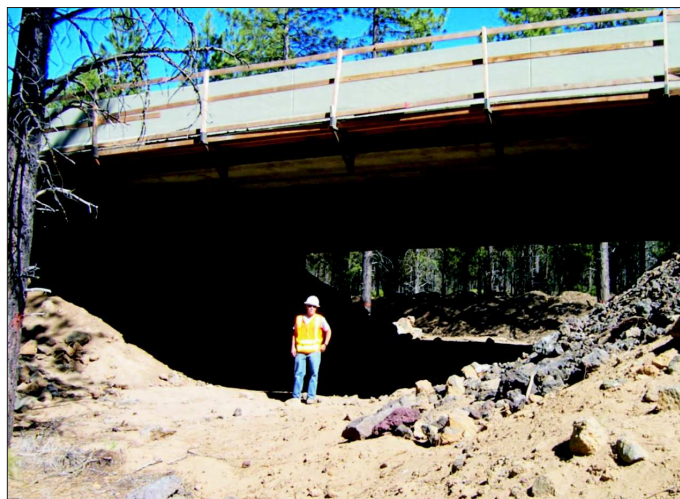
Fot. 2. Dolne przejście dla zwierząt umożliwiające im migrację pomiędzy siedliskami (US 97: LavaButte)
