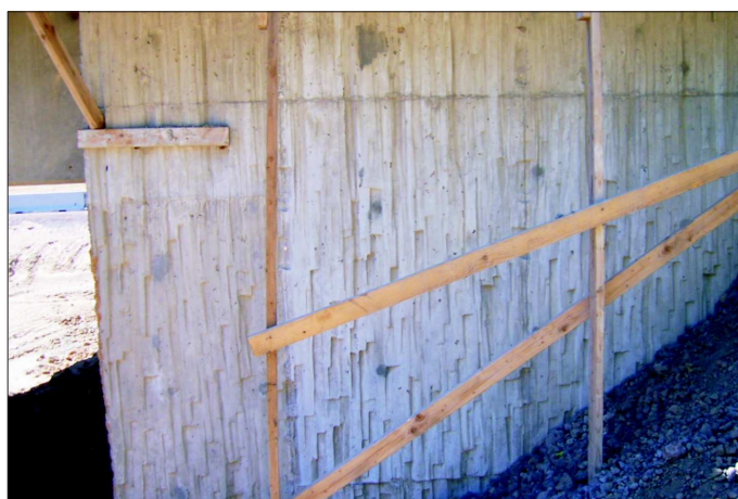
Fot. 3. Stworzenie miejsca bytowania nietoperzy. Konstrukcja mostowa została zaprojektowana w taki sposób, aby za pomocą perforacji i szczelin zapewnić miejsce gniazdowania nietoperzom. Za takie działania projekt otrzymał dodatkowe punkty
