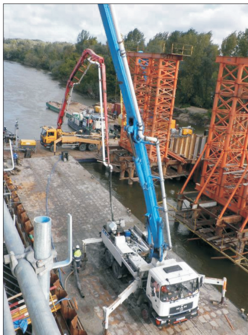
Fot. 12. Betonowanie podpory nurtowej P50 z barki; obok – podpory tymczasowe do montażu części podporowej
