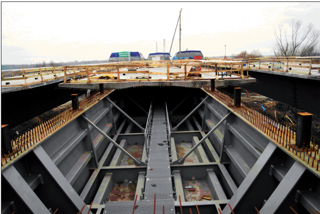
Fot. 29. Widok wnętrza skrzynki pomostu z łącznikami do zespolenia z płyty żelbetową
