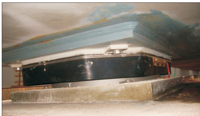
Fot. 1. łożysko garnkowe wielokierunkowo przesuwne na podporze P80
