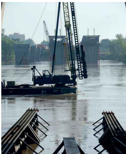
Fot. 36. Widok zalanych elementów konstrukcji mostu podczas wysokiej wody
