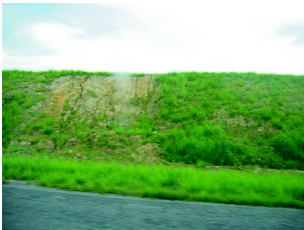
Fot. 3. Zniszczony ekran ziemny w wyniku ablacji (fot. D. Bęben)
