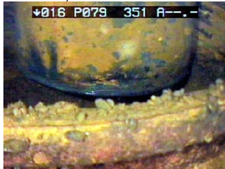
fot. 20. Uszkodzenie zagłowiczenia odwiertu B3-4BRe – obiekt podwodny zanurzony częściowo hydrotechniczny (badania własne)
