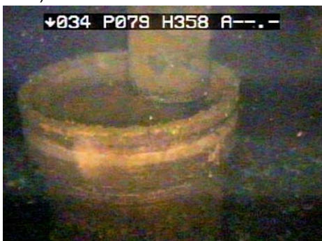
fot. 19. Fragment uszkodzonego zagłowiczenia odwiertu B3-4BRe – obiekt podwodny zanurzony częściowo hydrotechniczny (badania własne)
