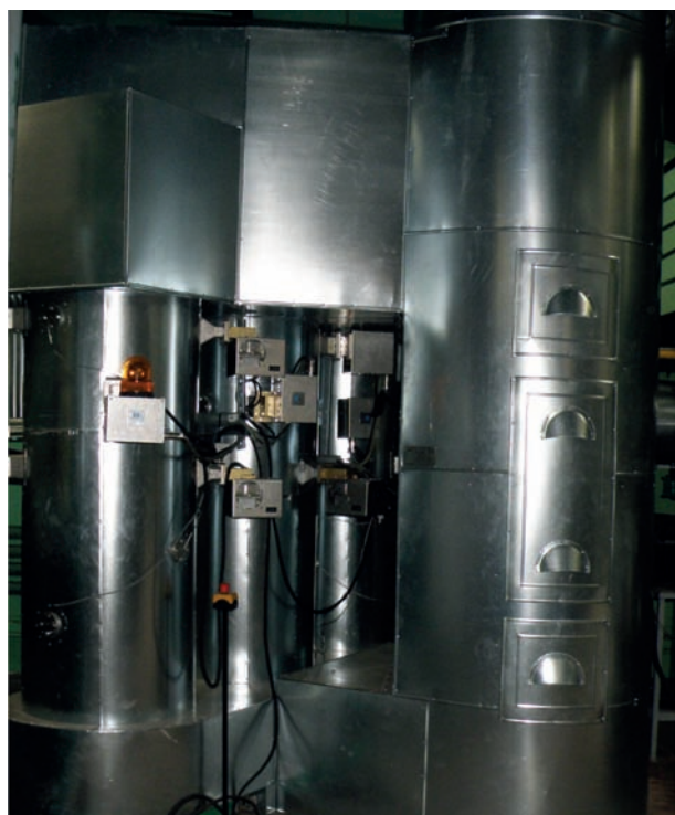
Rys. 4. Widok układu MOS zamontowanego w IMŻ
