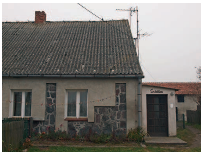
Ryc. 5. Grodzisko, przykład nieprofesjonalnie przeprowadzonej rewaloryzacji elewacji
