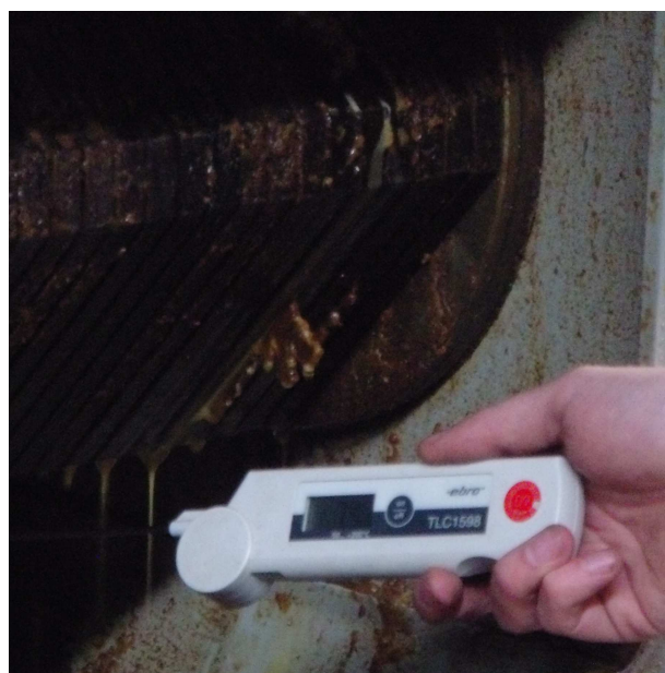
Rys. 3. Pomiar temperatury oleju wypływającego z segmentów obudowy ślimaka
