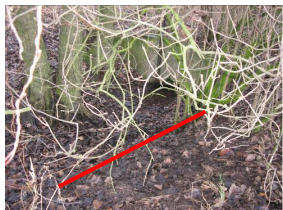
Rys. 9. Silne zamulenie i zadrzewienie rowu A-17 (gmina Kościan) w okolicy przepustu i rowu A-14, brak drożności Fig. 9. Strong silting and afforesting of the ditch A-17 (Community Koscian) in surroundings of the culvert and the ditch A-14, no patency
