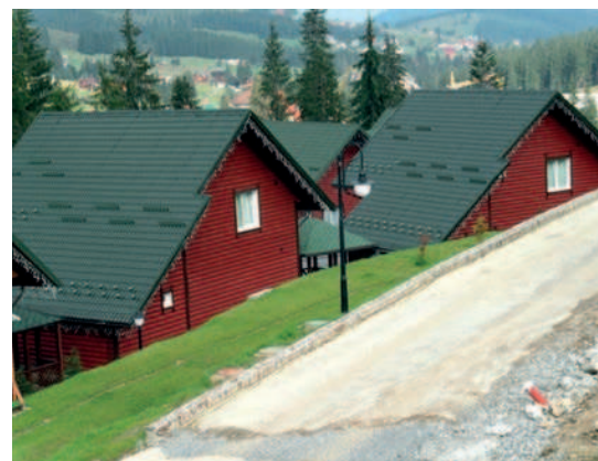
Ryc. 2. Droga zniszczona przez erozję
