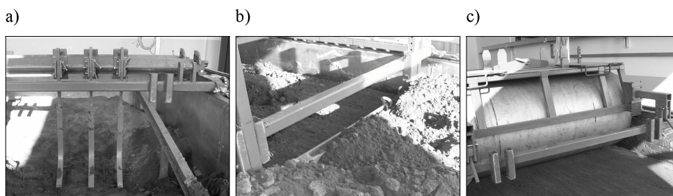
Rys. 4. Elementy wyposażenia do przygotowania gleby w kanale Fig. 4. Elements of equipment used to prepare soil in the channel
