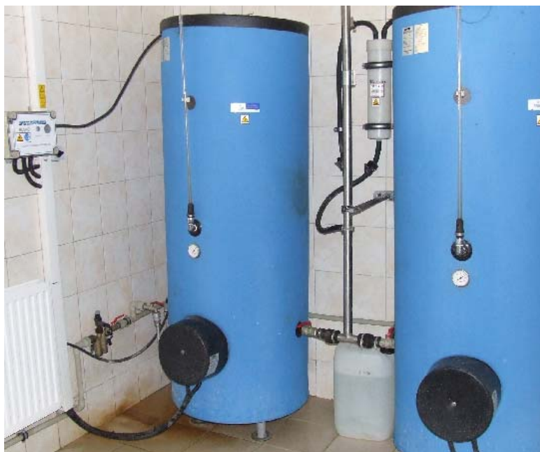
Rys. 2. Zbiorniki podgrzewające wodę do mycia instalacji nawet do temperatury rzędu 77-92°C
