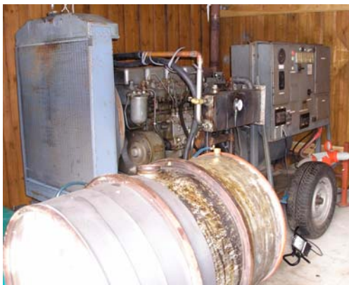
Rys. 3. Agregat prądowórczy z widocznym pierwszym stopniem wymiennika ciepła Fig. 3. Power generator with visible heat exchanger first stage
