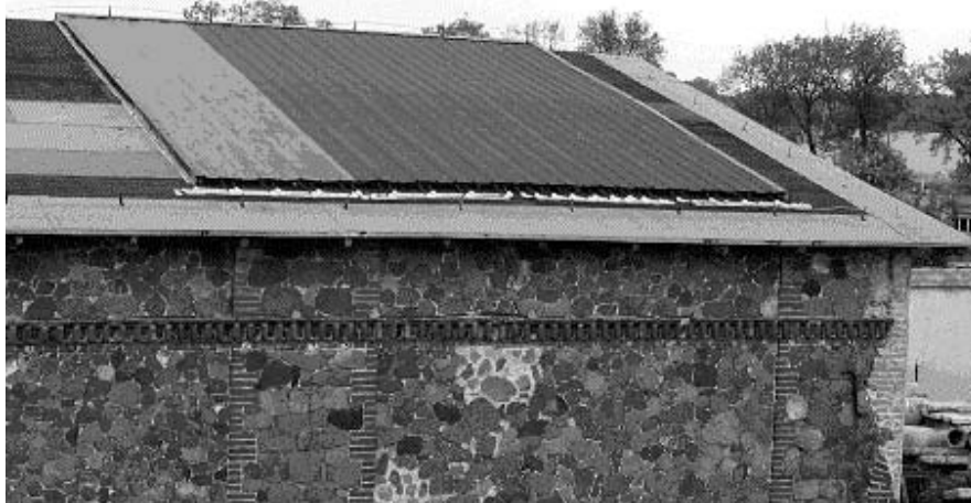
Rys. 2. "Dach energetyczny" na budynku magazynu w RGD Złotniki Fig. 2. "Energy roof" on the store-house in the Experimental Farm in Zlotniki
