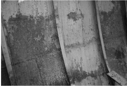
Rys. 7. Korozja wewnętrznej powierzchni burt
