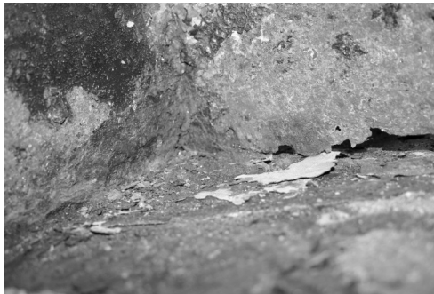
Rys. 8. Zniszczenia korozyjne wręgów i dna
