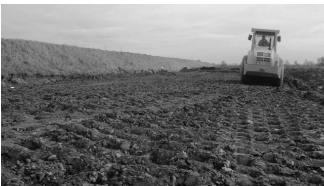
Rys. 6 Budowa wałów przeciwpowodziowych na Wiśle z zastosowaniem kruszywa „osuszonego” popiołem z ZG Janina
