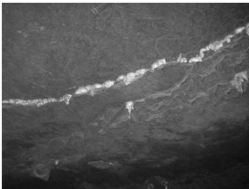
Rys. 5. Przykład uszczelniania pianką spękania stropowego
