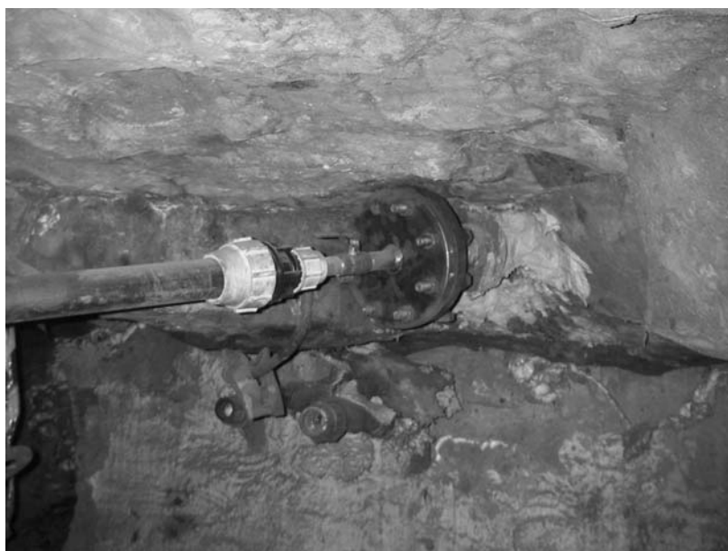
Rys. 6. Ujęcie gazu w otworze wiertniczym oraz rurociąg odprowadzający
