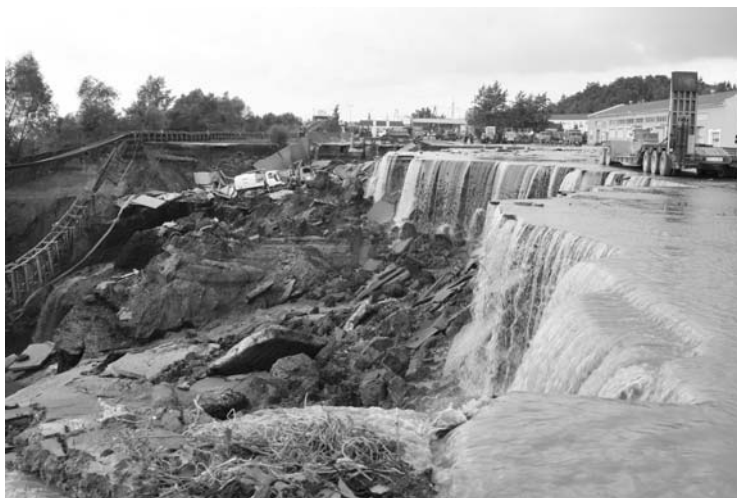
Rys. 3. Wdarcie się wody do odkrywki z rzeki Miedzianki w rejonie bazy transportowej i przerwanie ciągu ON-1
