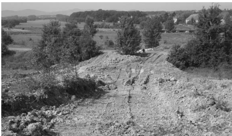
Rys. 7. Zlikwidowane dwa przebicia wody pod drogą Trzciniec–Sieniawka z rozlewiska Nysy Łużyckiej do odkrywki w dniach 7–8.08.2010 r.
