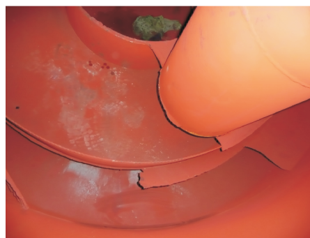
Rysunek 3 Zdjęcie wnętrza zbiornika ciśnieniowego wykonane podczas remontu w 2010 r. w EC Białystok
